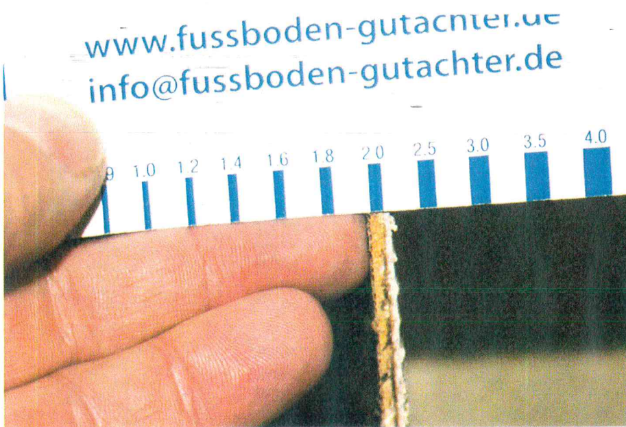
Das Foto zeigt eine asbesthaltige Flexplatte (ca. 2 mm) im Querschnitt und belegt die spröden Eigenschaften, welche für diese Altbeläge typisch sind.
